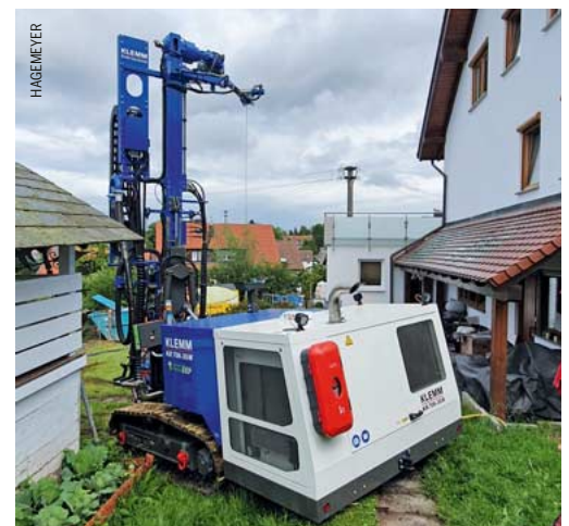
Das KR 708-3GW in der oberflächennahen Geothermiebohrung.
