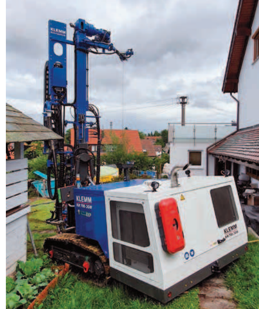
Erdwärmebohrungen im Bestand: Das besonders geländegängige KR 708-3GW Geothermiebohrgerät auf einer Einfamilienhaus-Baustelle.
